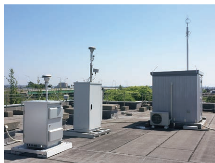
ACAP屋上に設置されたモニタリング機材
